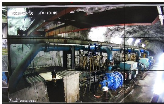
圖 3 自動化泵站運行現場圖
